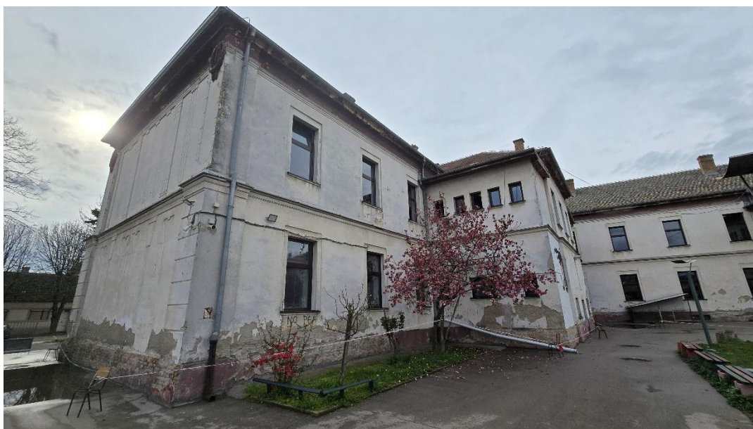
nepravilno odvodnjavanje kišnice na levom delu slike
