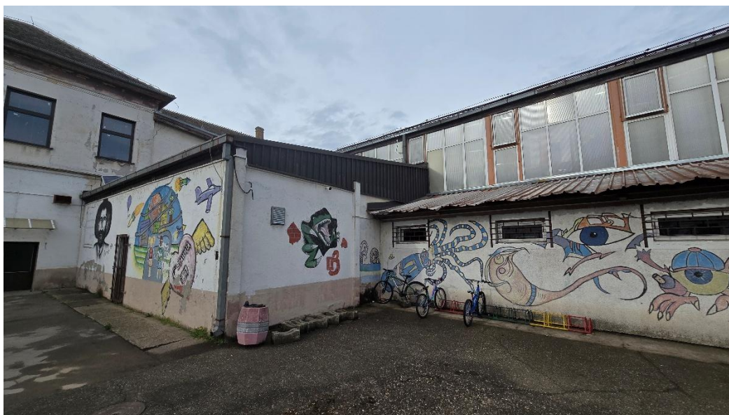
pukotine na trotoarima
